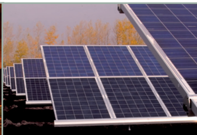
Photovoltaikanlage für Q-Sells, Finsterwalde
