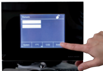
Touchpanel BUS-System, komplette Haus- elektrik mit ein paar Handgriffen navigierbar!
